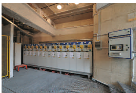
西班牙公用变电站
